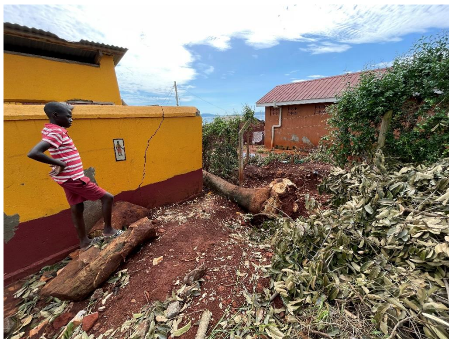
Een mangoboom van de burens bleek “verwoestend” actief... inmiddels boom verwijderd, muur vervangen en alles weer up to date.
